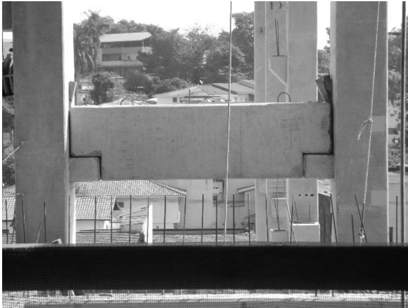
Figura 44: Problemas de montagem
