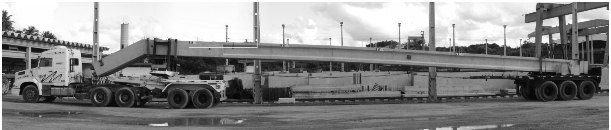
Figura 40 – (a) Montagem e (b) Transporte de vigas pré-moldadas de grande comprimento para área de armazenamento da Fábrica de Fertilizantes Nitrogenados, em Laranjeiras, SE
