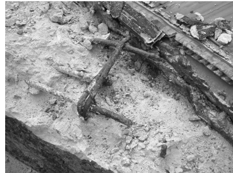
Armadura longitudinal e transversal cortadas
