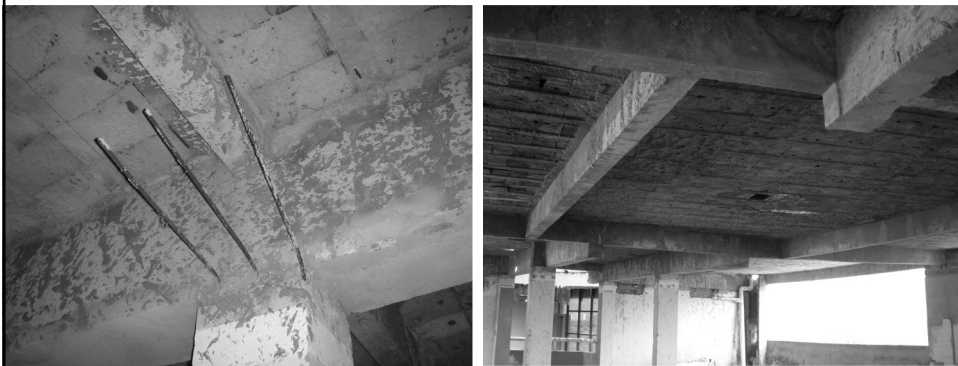
Pilar com alojamento incorreto de armaduras
