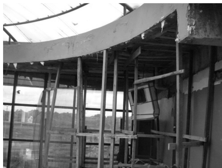
Região do Atrium escorada e sem estabilidade
