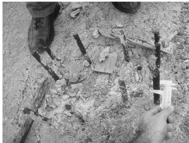
Falta de arremate na armadura dos pilares (100% dos pilares)
