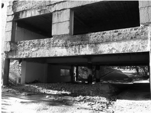
Viga com altura insuficiente para o vão.
