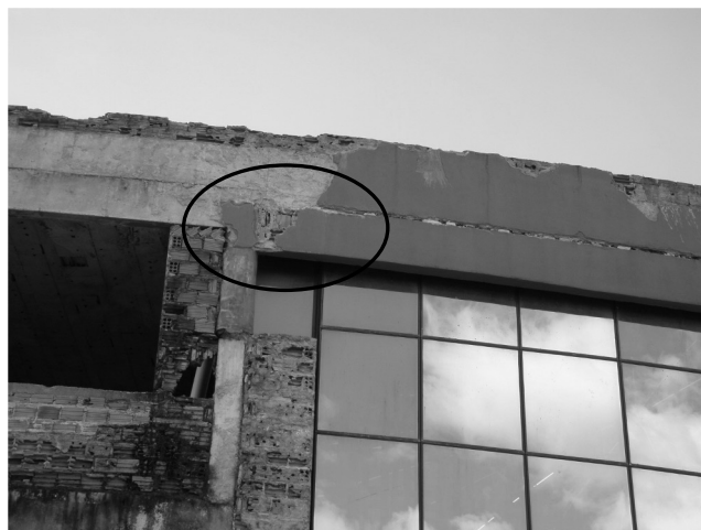
Viga com seção insuficiente e vão preenchido com alvenaria
