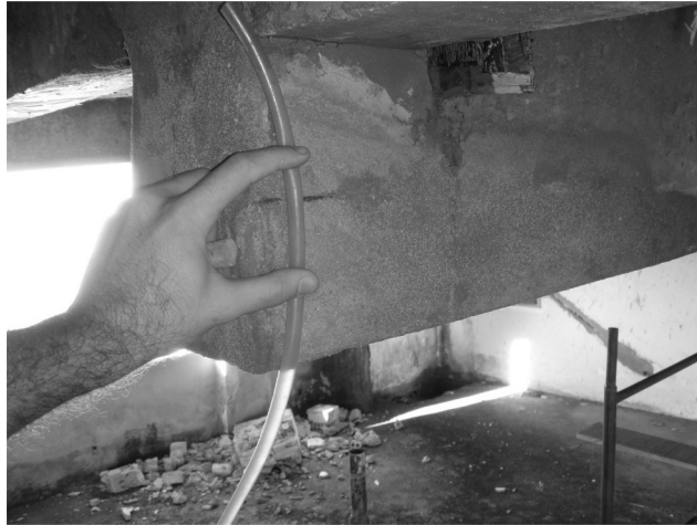
Flechas elevadas nas vigas.
