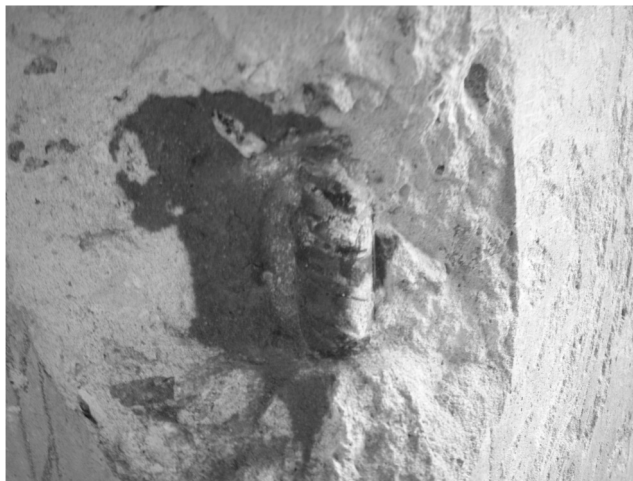
Medida da profundidade de carbonatação e Penetração de cloretos
