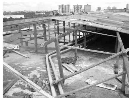
Cobertura com água acumulada sem ralos
