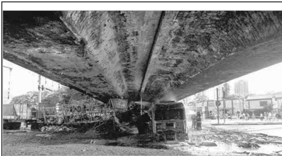
► Figura 1 Vista inferior do vão central do Viaduto Santo Amaro, após ser atingido por incêndio
