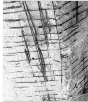
► Figura 8 Detalhes da região do viaduto mais afetada pelo incêndio, onde é possível ver as bainhas de protensão
