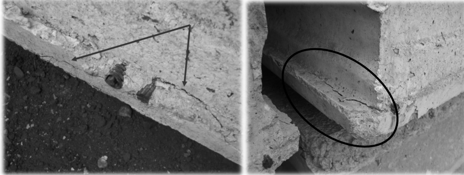
Fissuras na borda do painel alveolar
