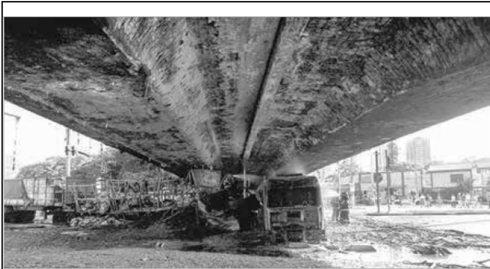
► Figura 1 Vista inferior do vão central do Viaduto Santo Amaro, após ser atingido por incêndio
