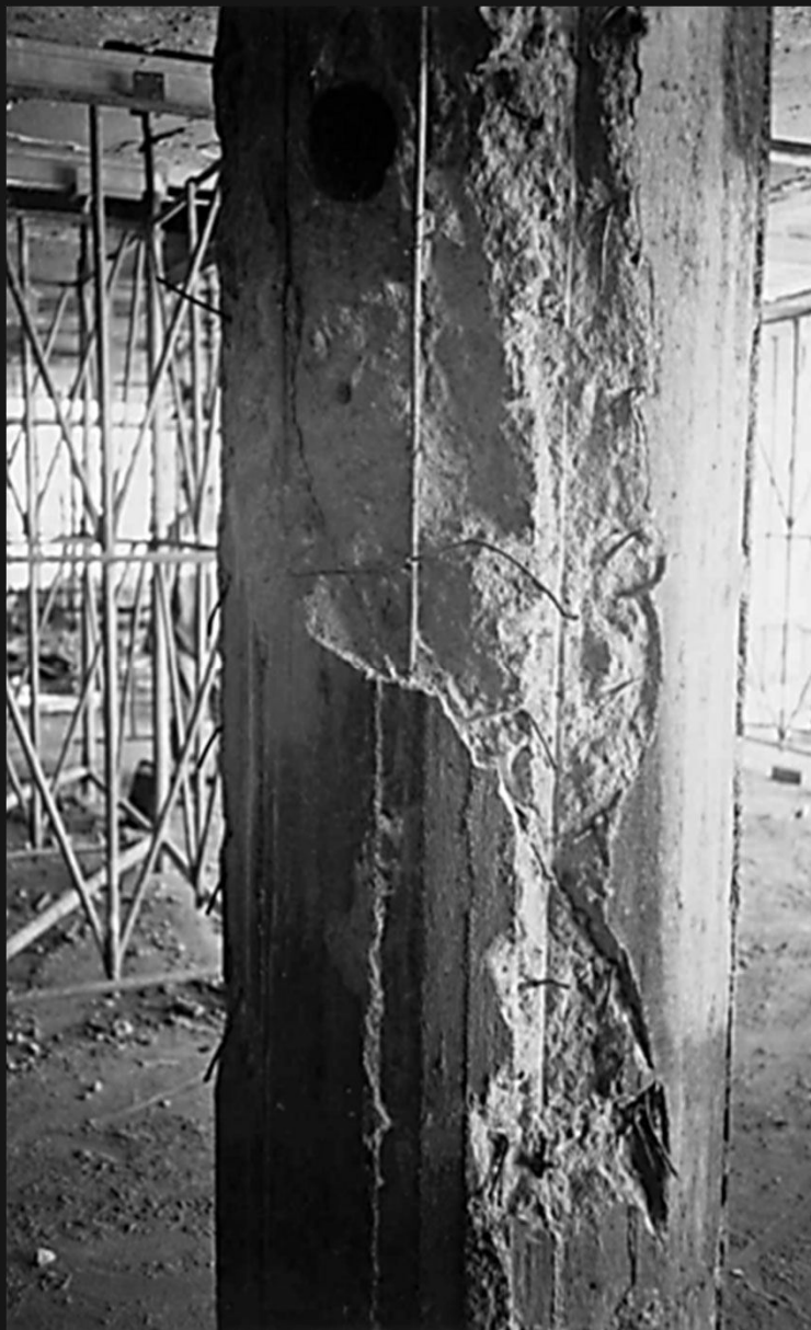
Ruptura de um pilar do 2º teto
