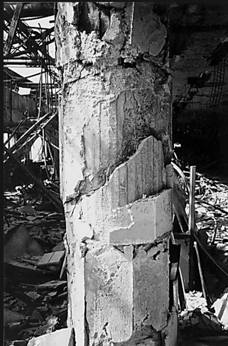
Ruptura de um pilar do 3º teto
