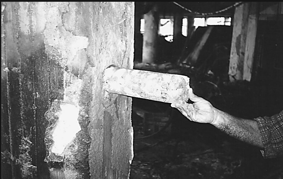
Amostra de concreto extraída de pilar danificado do 2º teto
