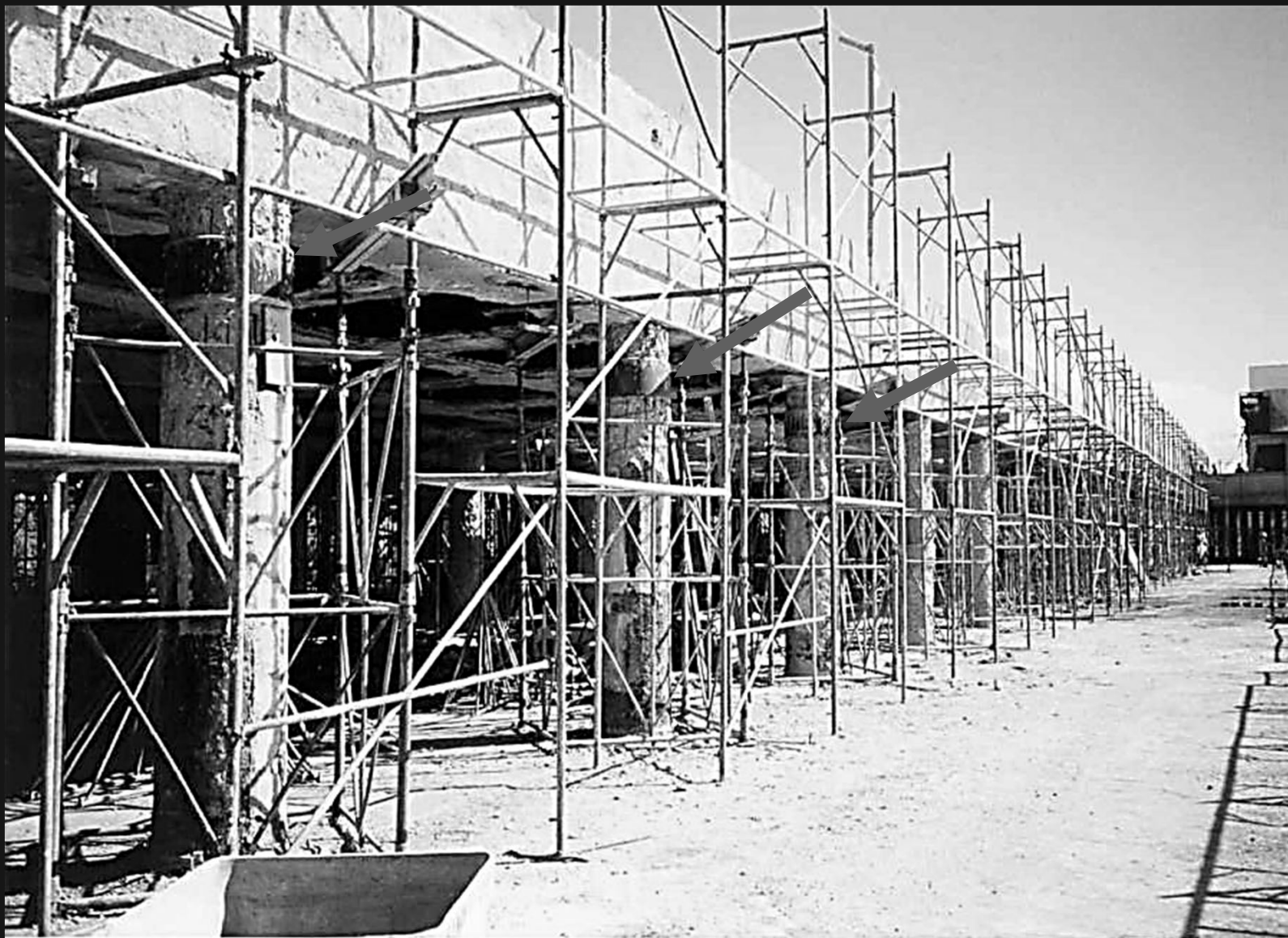
Pilares rompidos (3º teto) com cintamento já executado
