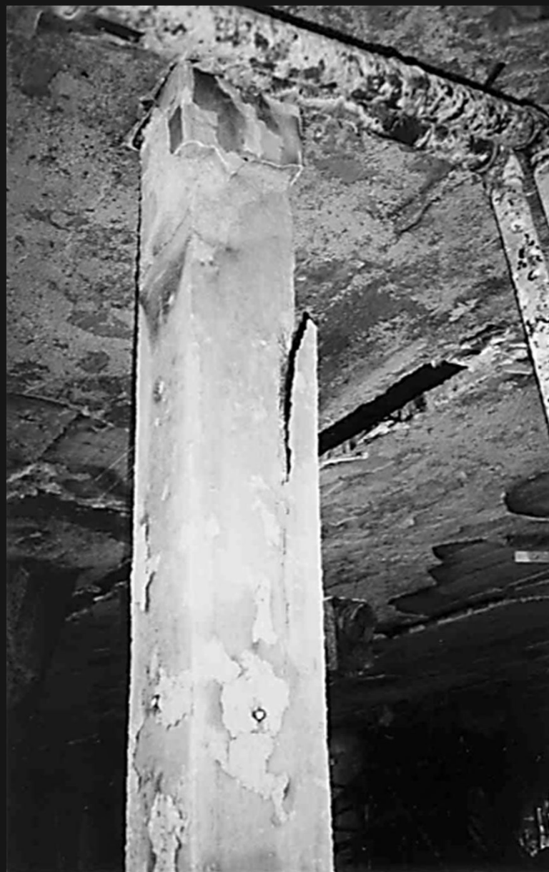
Grande "lascamento" do concreto na aresta de pilar retangular do 2º teto, localizado na área de projeção do saguão principal
