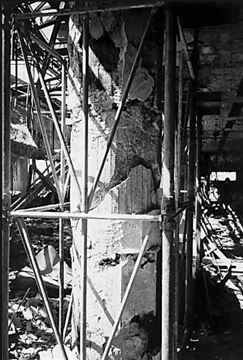
Escoramento entre pisos em torno de um pilar rompido do 3º teto.
