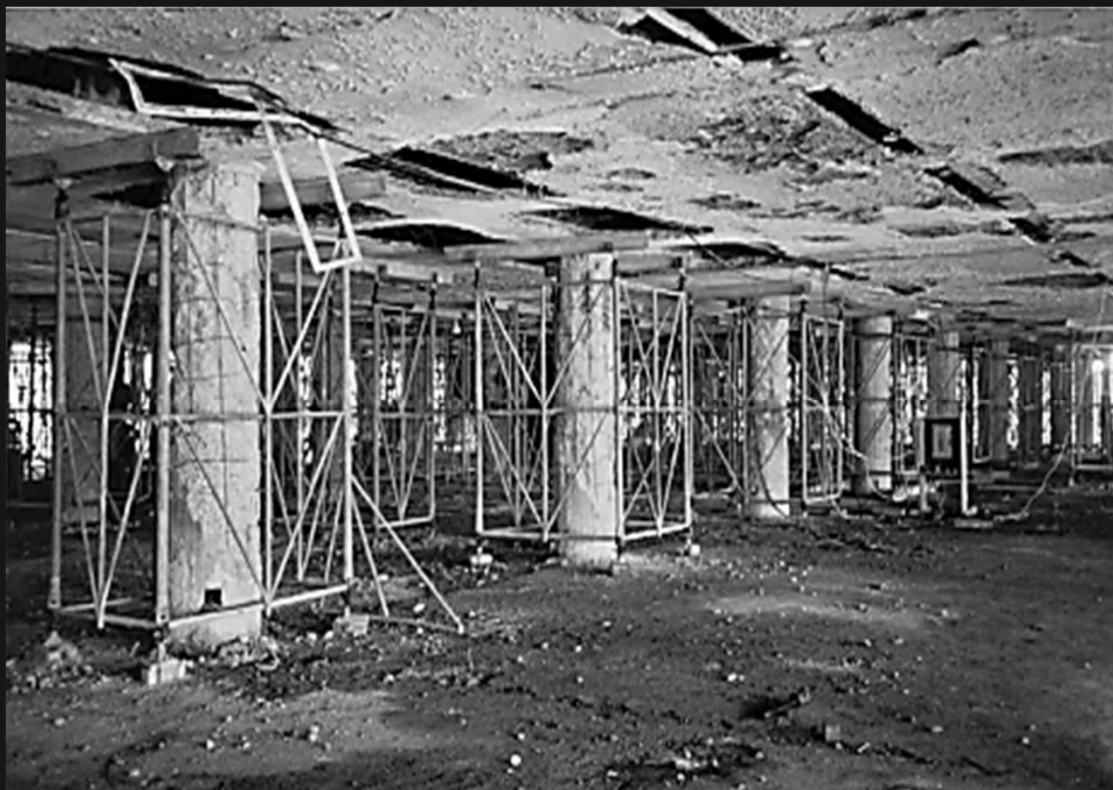
Linha de pilares de seção circular do 2º teto dentro dos escoramentos entre pisos. Painéis de laje de forro bastante danificados
