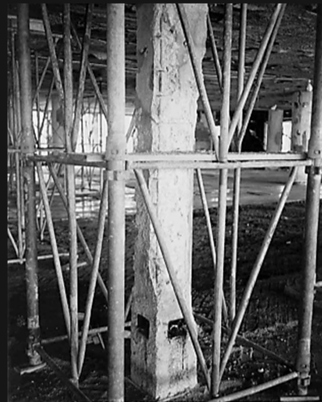
Pilar de seção retangular do 2º teto dentro de escoramento entre pisos.
