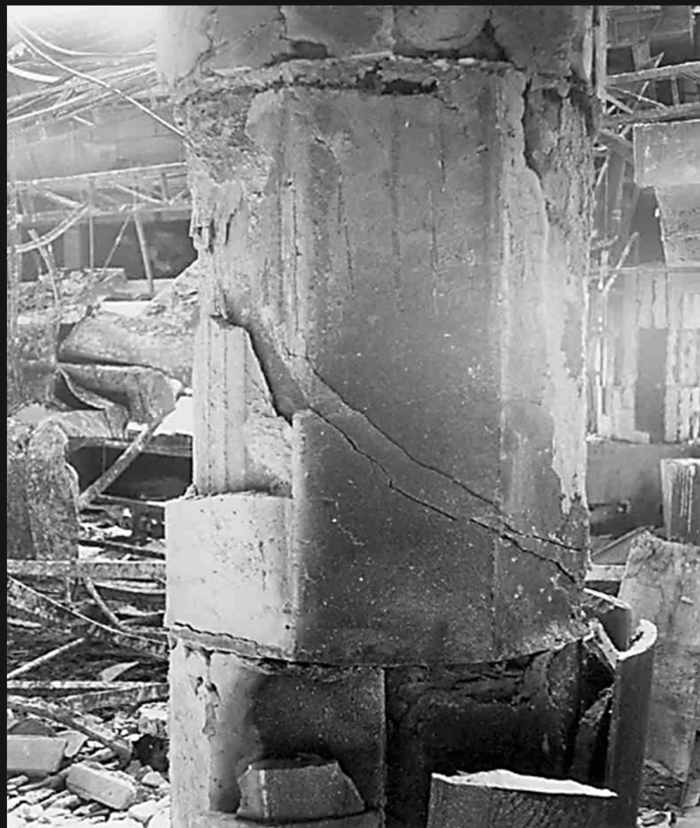
Ruptura de um pilar do 3º teto Nota-se a ruptura do reboco e das placas de revestimento
