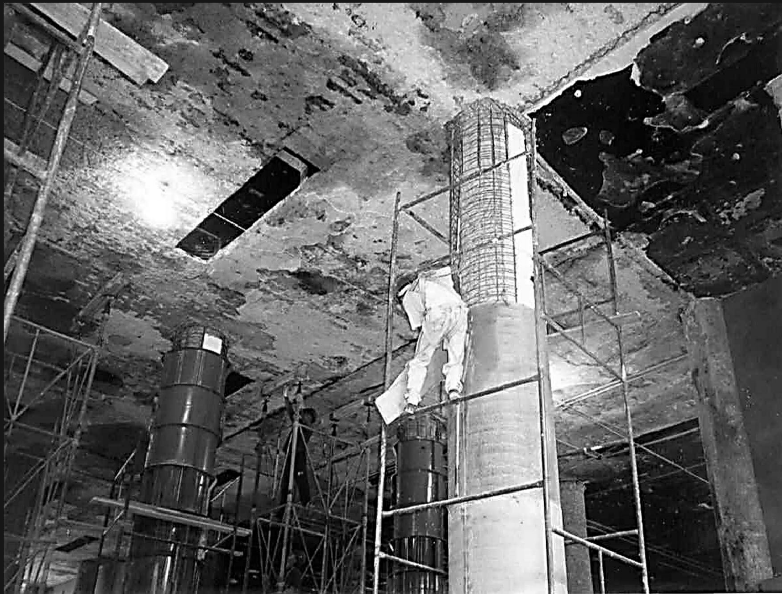
Detalhes das cambotas metálicas empregadas para execução do reforço por cintamento e encamisamento dos pilares do saguão
