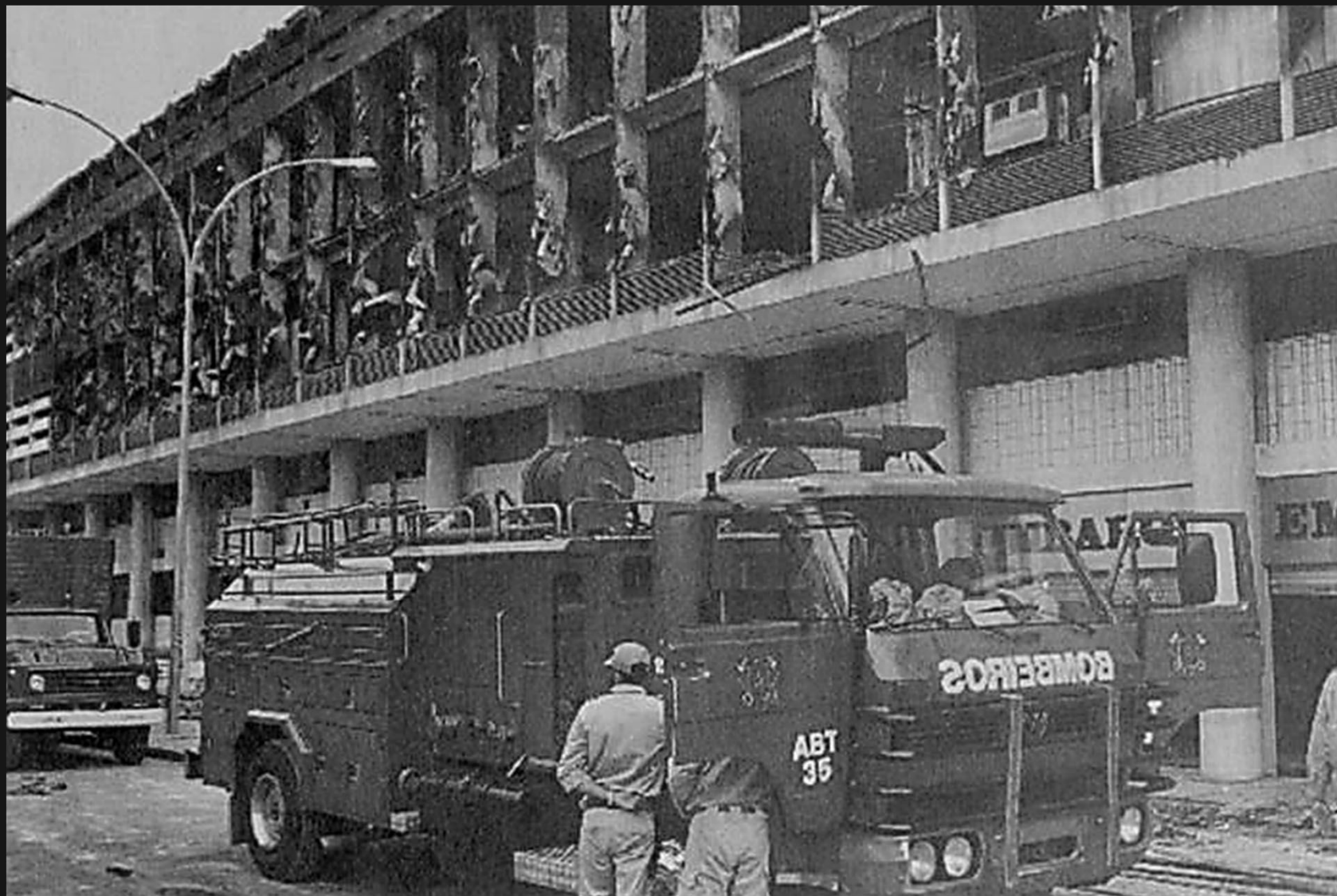
Vista da fachada principal durante operação de rescaldo do prédio, no dia 14/02/98
