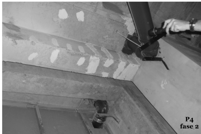
Fissuras em Vigas
