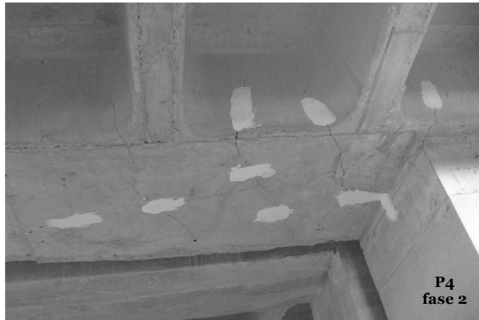
Fissuras em Vigas
