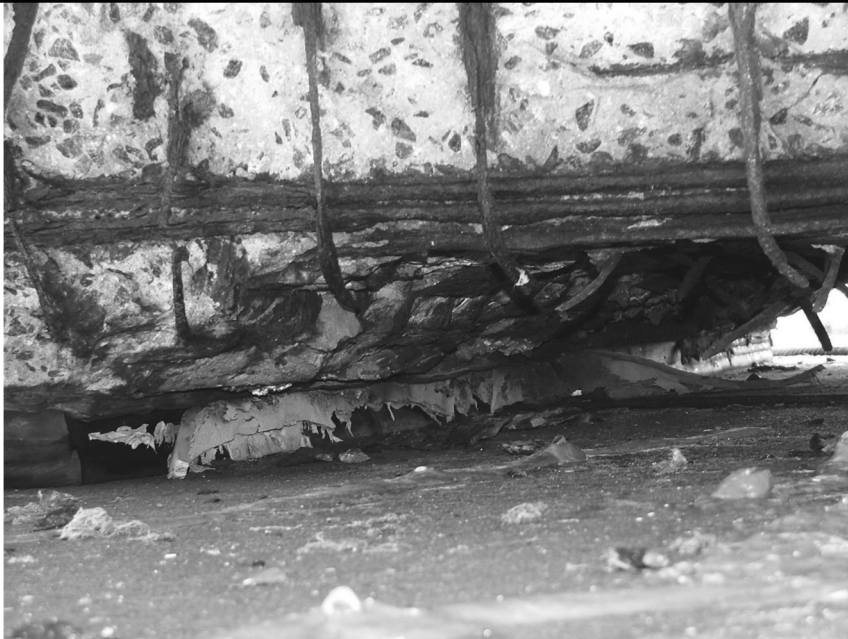
Armadura → Corrosão por cloretos
