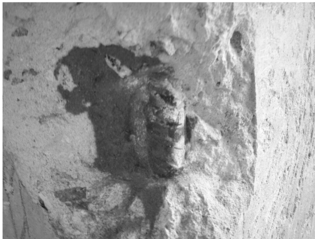
medida da profundidade de carbonatação
