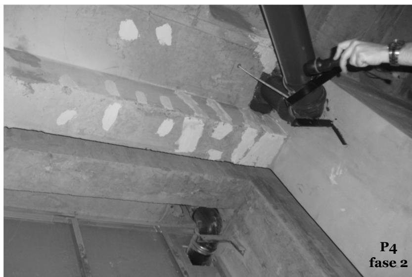
Fissuras em Vigas
