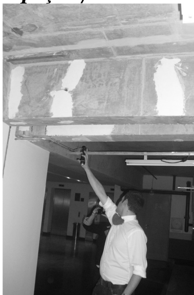
Desnivelamento e fissuras em vigas
