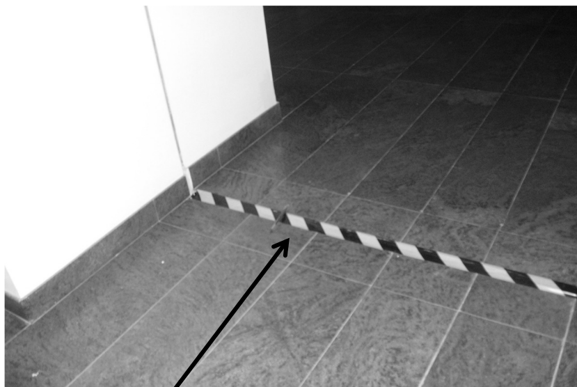
Desnivelamento nível S3
