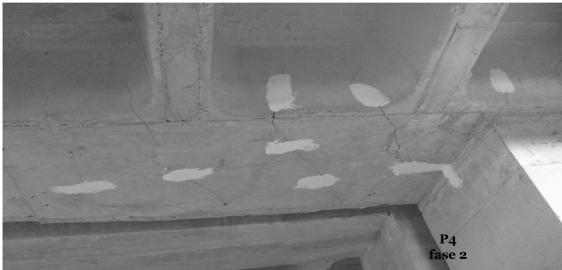
Fissuras em Vigas
