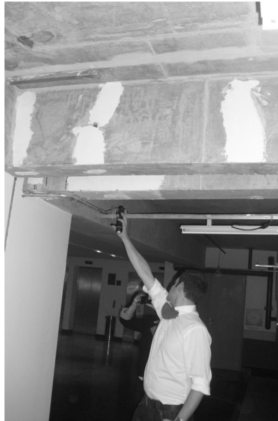
Desnívelamento e fissuras em vigas
