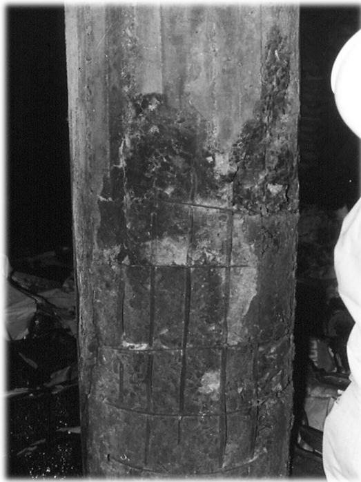
aspecto típico dos pilares pós incêndio
